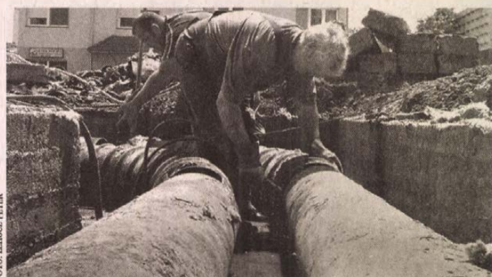
A kilyukadt vezetékét korszerű, előszigetelt csőre cserélték
